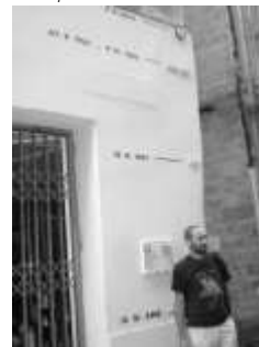
De nombreuses inondations marquées sur le mur.
